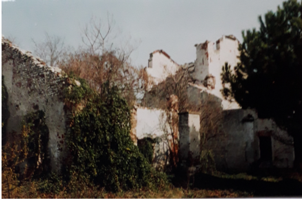
Figura 27. Foto del 1993 che attesta il crollo della copertura e della parete ovest della torre. (Archivio Patrimonio SABAP-Vr)
