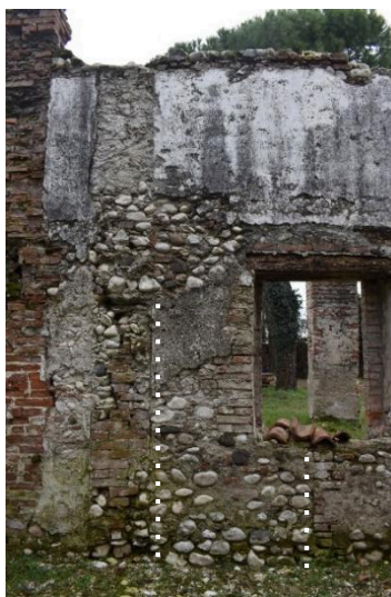
Figura 37. Tracce di spallette sulla controparete sud.
