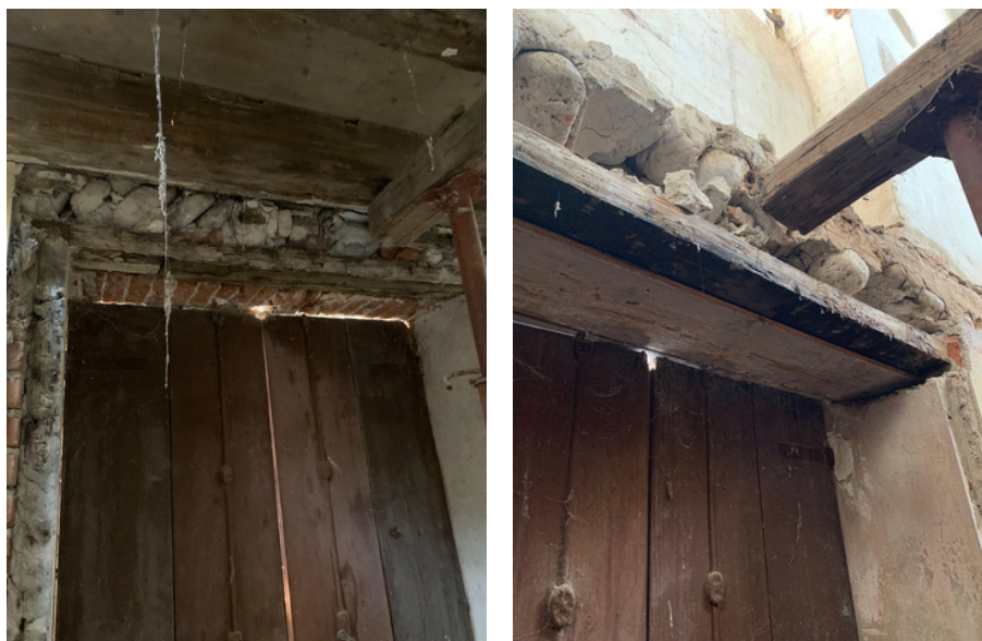
Figura 4: Situazione degli architravi delle finestre prima del recente consolidamento strutturale.
