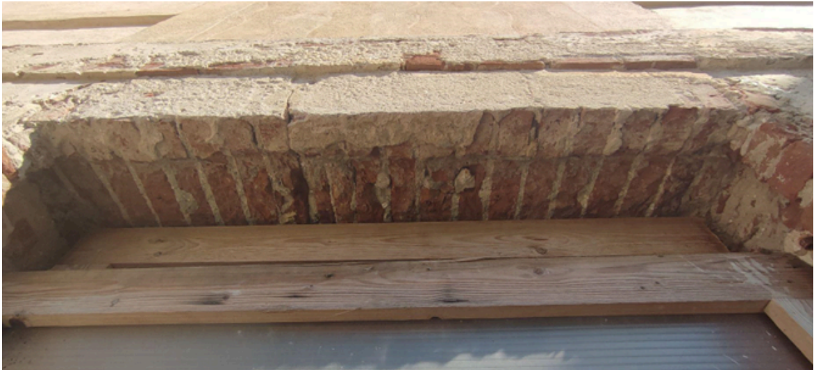
Figura 14 bis: Intradosso dell'architrave verso l'esterno della finestra 5.
