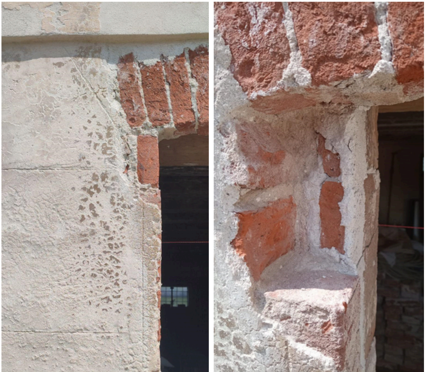
Figura 12. A sinistra disegno del bugnato sulla spalletta ovest della finestra 1; a destra rimozione dei pezzi di mattone di imposta della piattabanda da cui emerge un mattone inclinato sopra ad una tavella.
