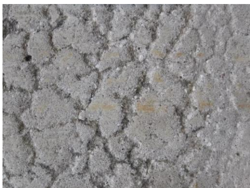
Degrado tipico dell'intonaco
