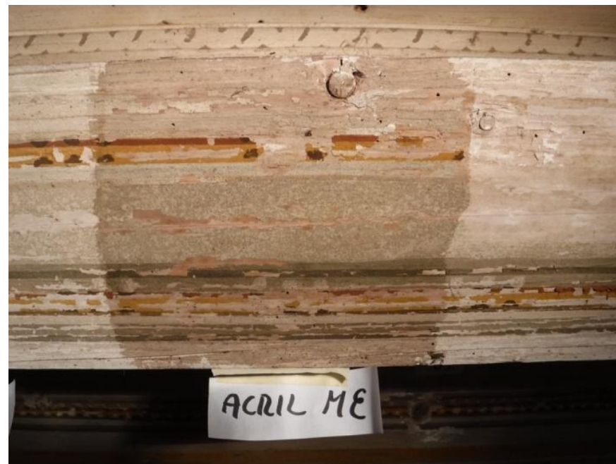
Campione di pre-fissaggio sulle travature decorate a tempera del Salone
