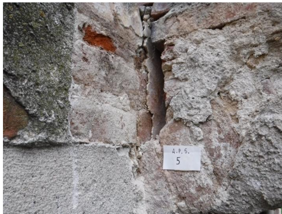
Assenza di ammorsatura tra pareti scala e loggia
