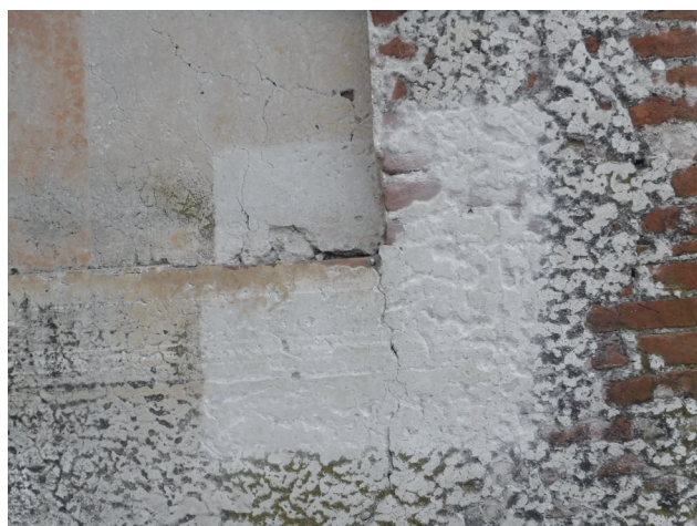
Fig. 3. Campione di pulitura di intonaci esterni caratterizzati da grave infestazione biologica.
