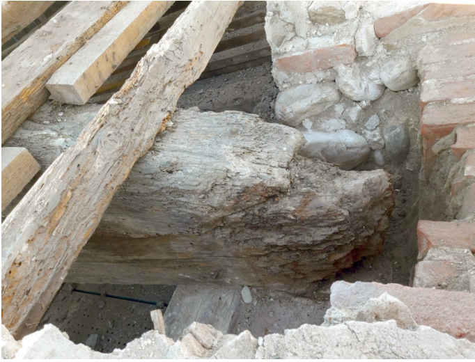
Fig. 6. Esempio di marcescenza della testa di una trave dell'orditura primaria della copertura della villa.
